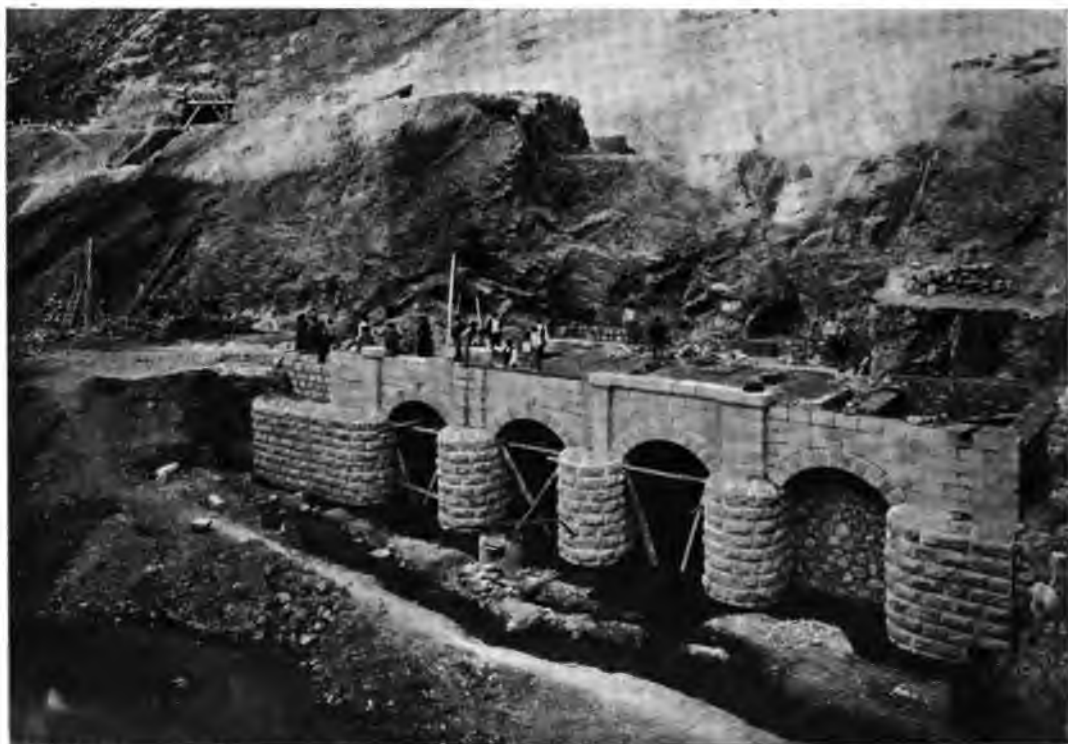
IMPIANTO IDRO-ELETTRICO PRESSO CAPISTRELLO UTILIZZANDO LE ACQUE DELL'EMISSARIO.
